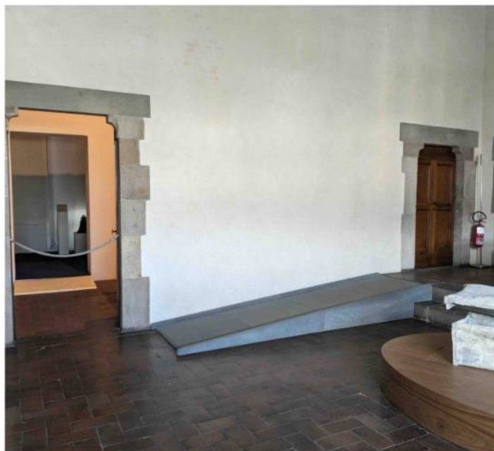
Rampa interna al piano primo Aggiungere corrimano/sicurezza
